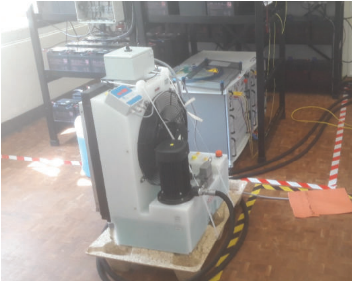
Abbildung 7-6: Externer Teil des Kühlsystems im EFZN-Labor in Goslar
