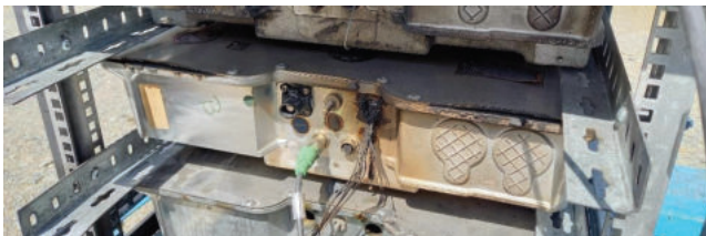
Abbildung 5-60: Vorderseite Havarie-Rack – BV mit BS
