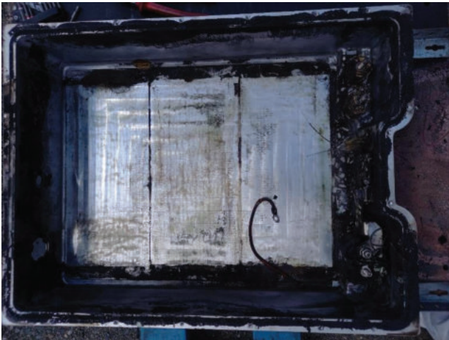
Abbildung 5-63: Boden des havarierten Racks – BV mit BS
