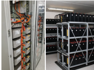
Abbildung 3-78: Eingesetzten Lithium-Ionen-Batterie-Systemen (links) und getestetes Blei-Säure-Batteriesystems (rechts) in der Feldumgebung des EnergieCampus des EFZN/TUC
