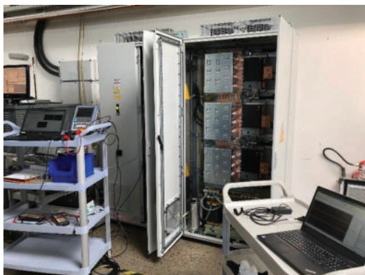
Abbildung 8-22: Laboraufbau mit Stromrichter von Pilot 2 für Inbetriebnahme des Gesamtsystems in Goslar
