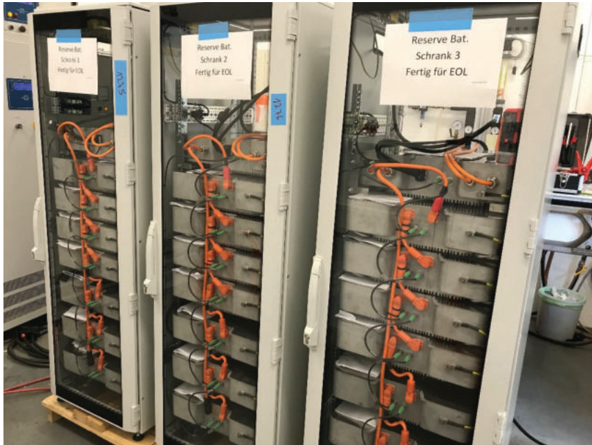
Abbildung 4-3: EOL-Test des Batteriesystem bestehend aus den drei Batteriesträngen (Rack-Schränken). Die Junction Box und der MSM sind auf dem Bild nicht zu sehen.
