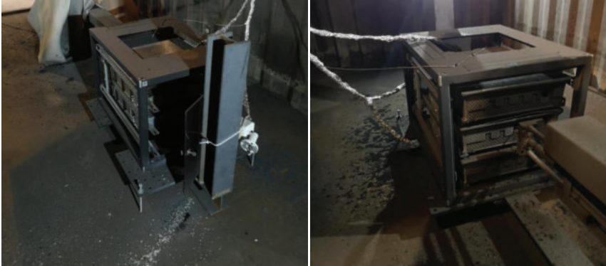
Abbildung 5-38: Starke Verschmutzungen im Prüfraum – BV ohne BS
