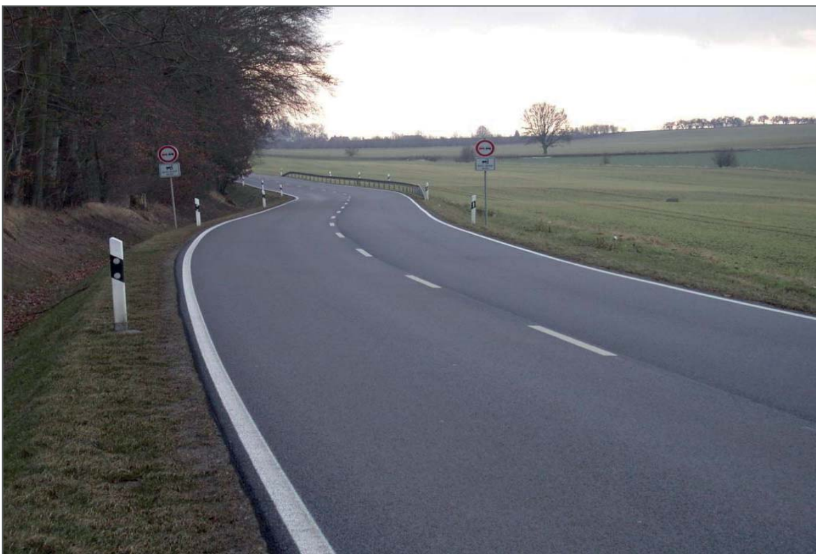
Abbildung 3: Einbahnig zweistreifige Landstraße mit Regelquerschnitt RQ 11 der EKL 3 (Foto: Lippold, TU Dresden)
