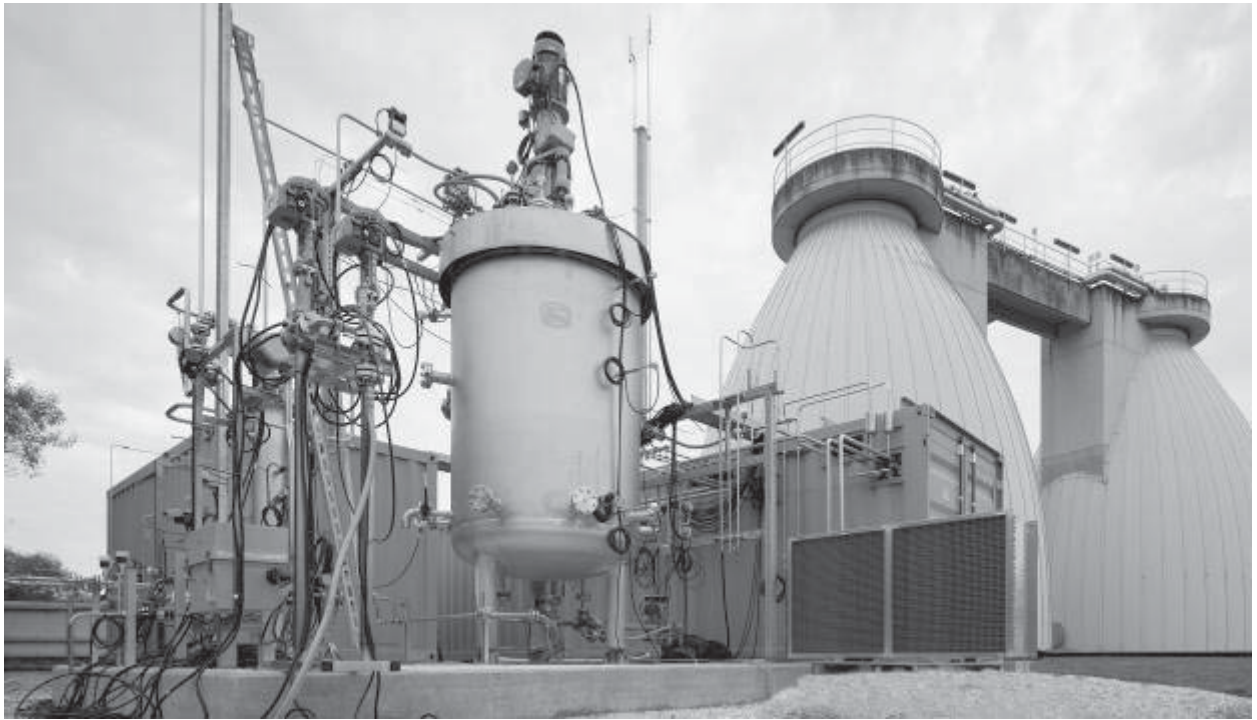
Abb. 1: Mikrobiologische Methanisierung am Klärwerk Schwandorf
