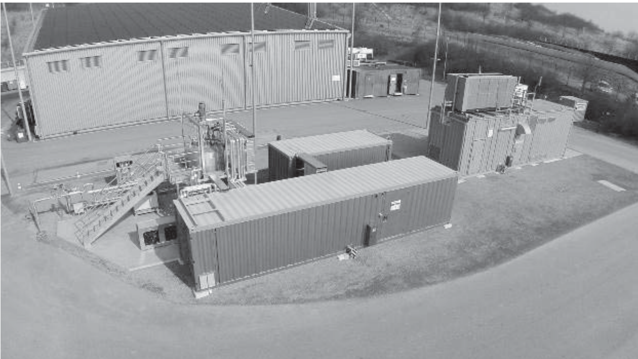
Abb. 3: Power-to-Gas-Anlage am Standort Allendorf (Inbetriebnahme: März 2015)
