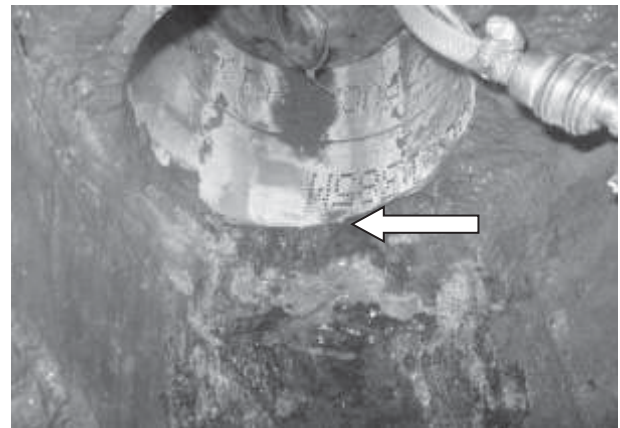
Abbildung 24: Undichte Leitungsanbindung an den Schacht D10a
