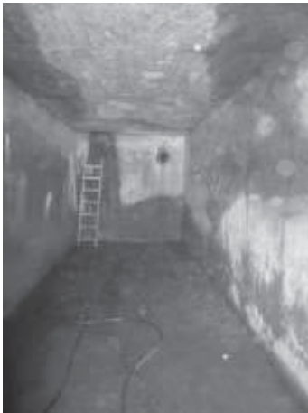
Abbildung 35: Sickerwassertank vor und ...
