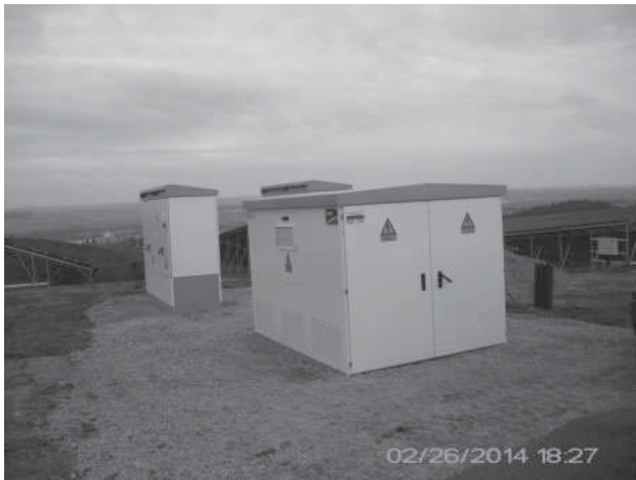
Abbildung 8 Transformator und Wechselrichter auf Deponiekörper
