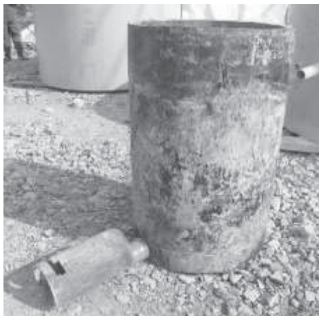
Abbildung 5: Ursprüngliche Situation an der Basis der Sickerwasserschächte
