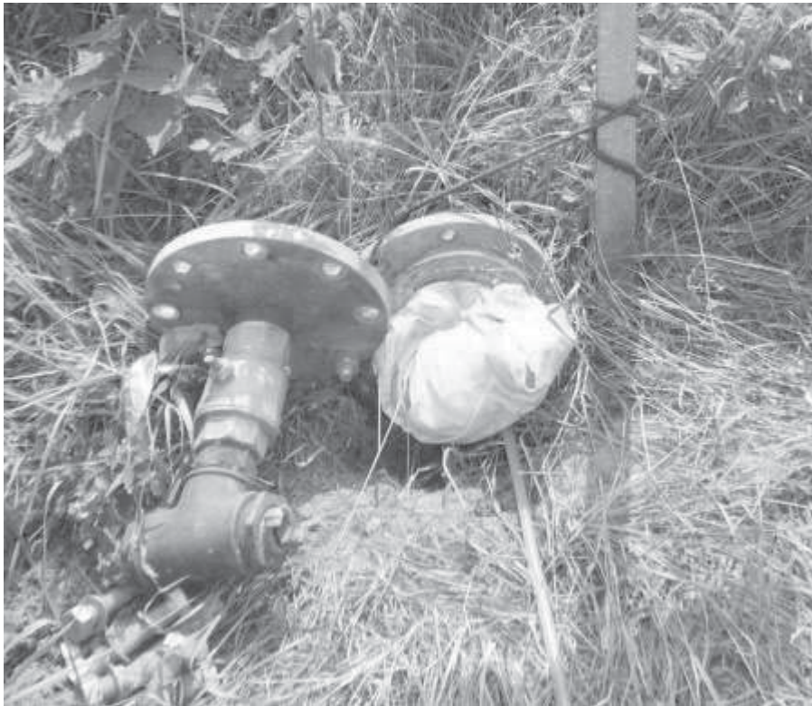
Abbildung 6: Entnahmeschlauch am Rohrende der Entgasungsleitung
