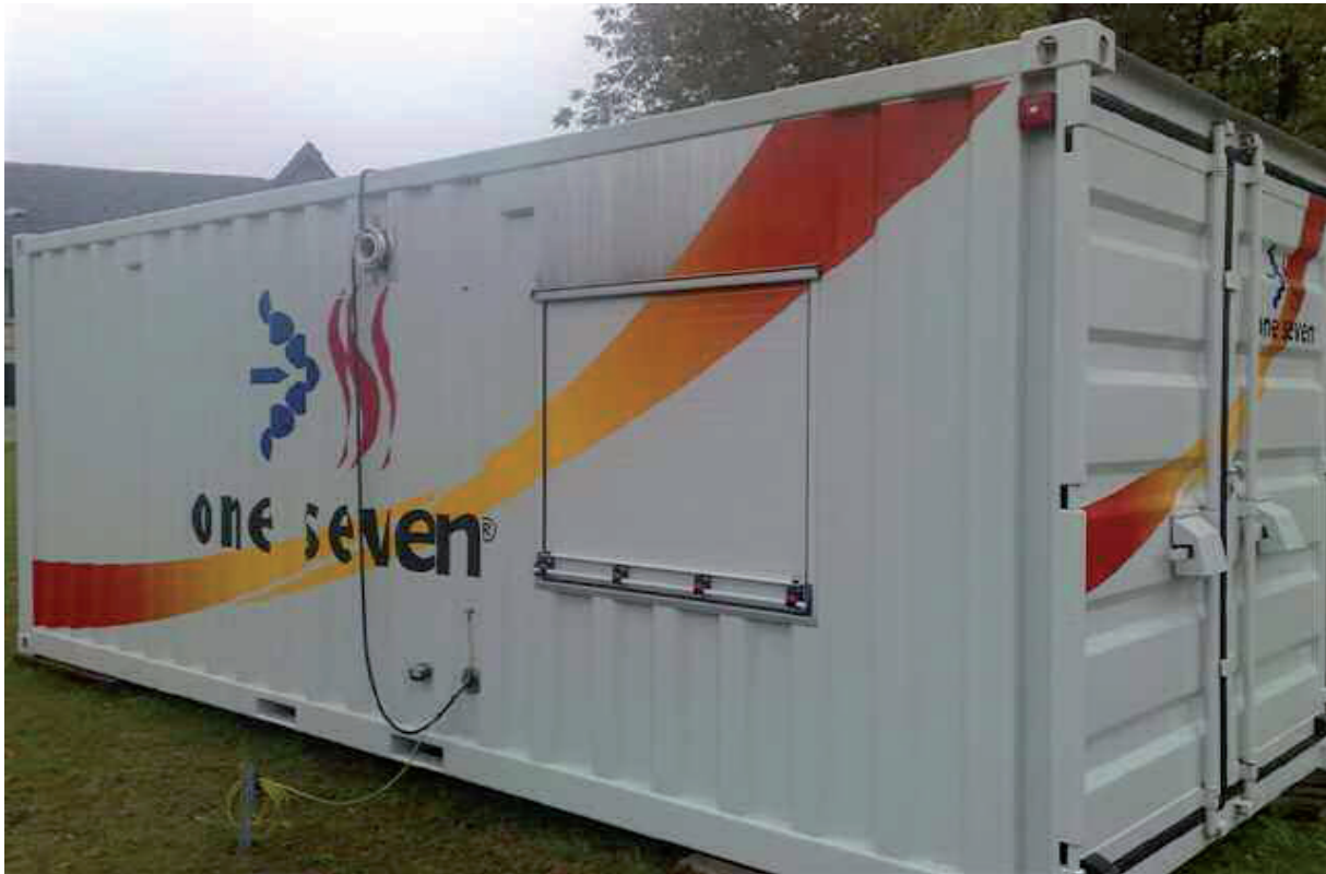
Abbildung 6 - One Seven® Löschanlagenzentrale in einem Container
